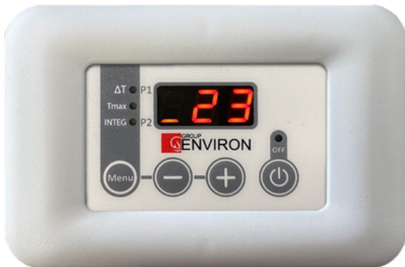
Temperaturanzeige Pufferspeicher oben / Schwimmbad (T3)
